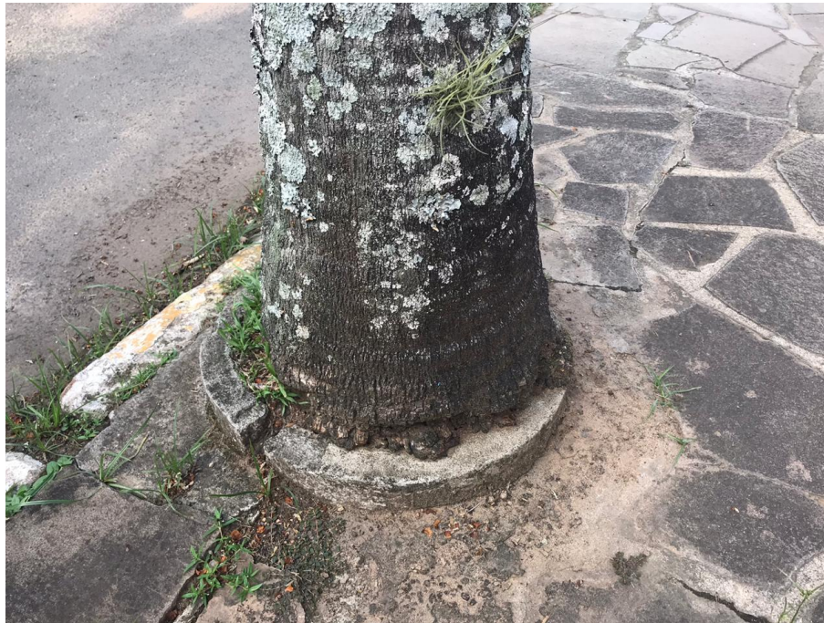
Figura 51 – Manilha de concreto “estrangulando” raízes.
