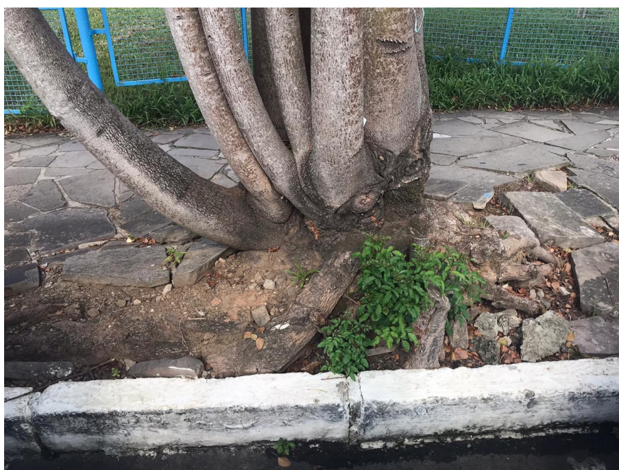
Figura 56 – Arbóreo com diversos ramos codominantes e raízes superficiais danificando o passeio.
